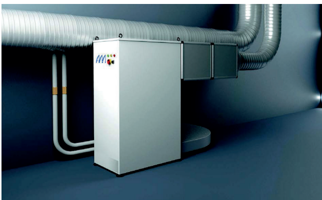
Installatie in een machinekamer
